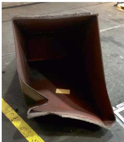
Bild 6: Plötzlich abgerissene Kranbahnkonsole (Blick auf die gerissenen Schweißnähte zur Stütze); Die Beulverformung entstand nach dem Abreißen der darüber liegenden Schweißnähte.
