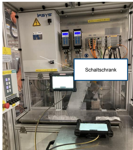
Abbildung 64: Steuerung der Vereinzelungsanlage
