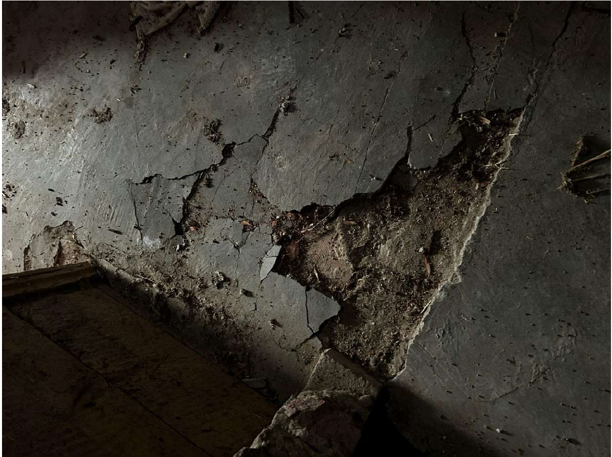
Abbildung 7.5: Aufgeplatzter Estrich im Obergeschoss
