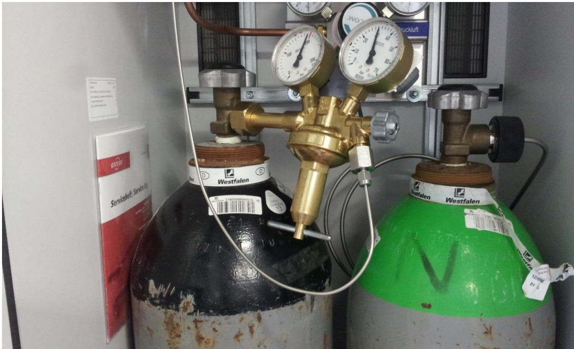
(Abbildung 6: Stickstoffflasche mit Reduzierventil)
