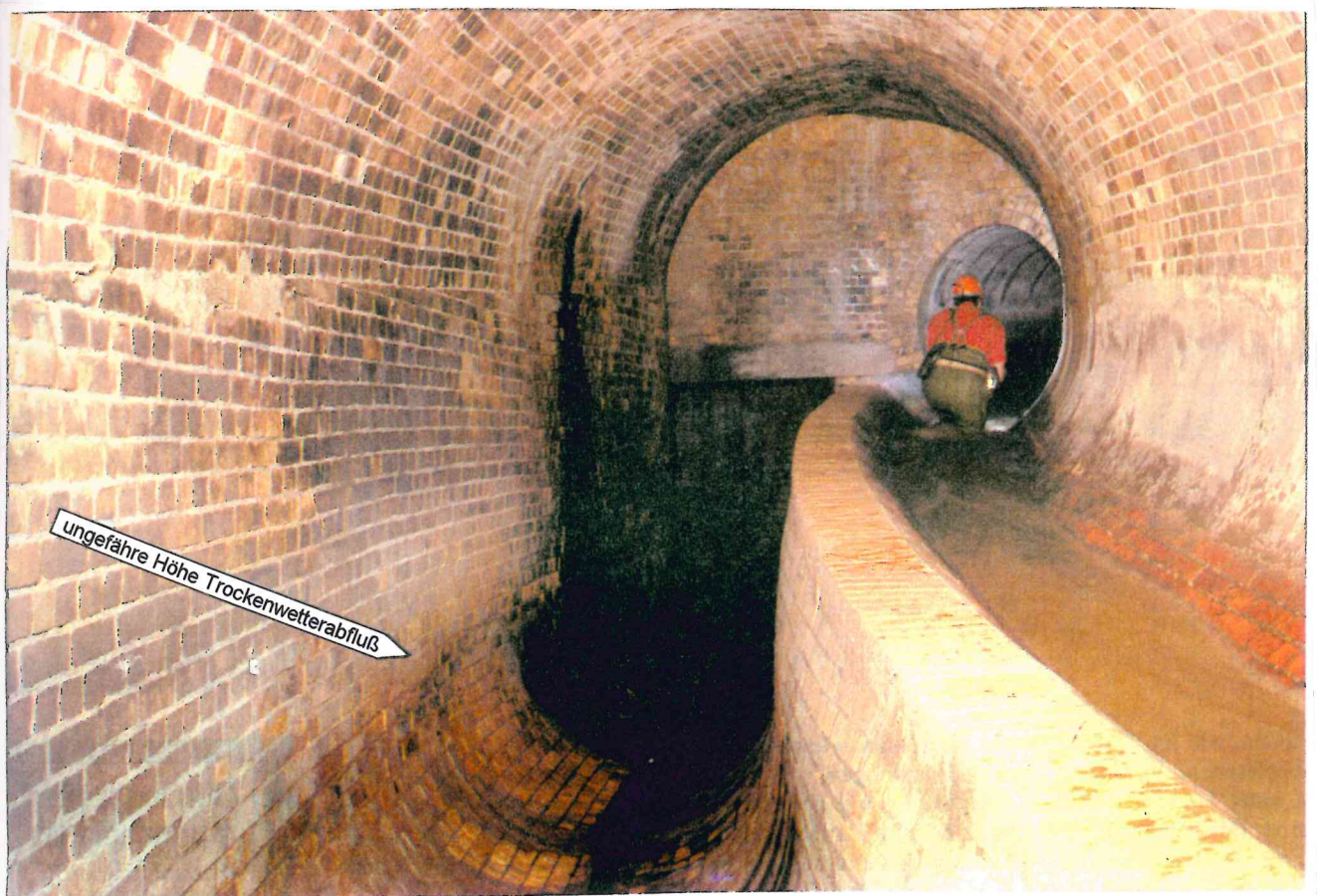
Abb.5.1.14: Hauptsammler zur Kläranlage Trotha (Foto aus: HWA-GmbH 1994)
