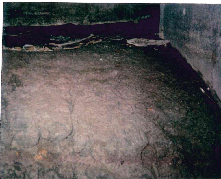
Abb. 5.1.8: Schlammablagerungen in der Gerberröhre mit auflagernden kanalisationstypischen Schwimmstoffen
