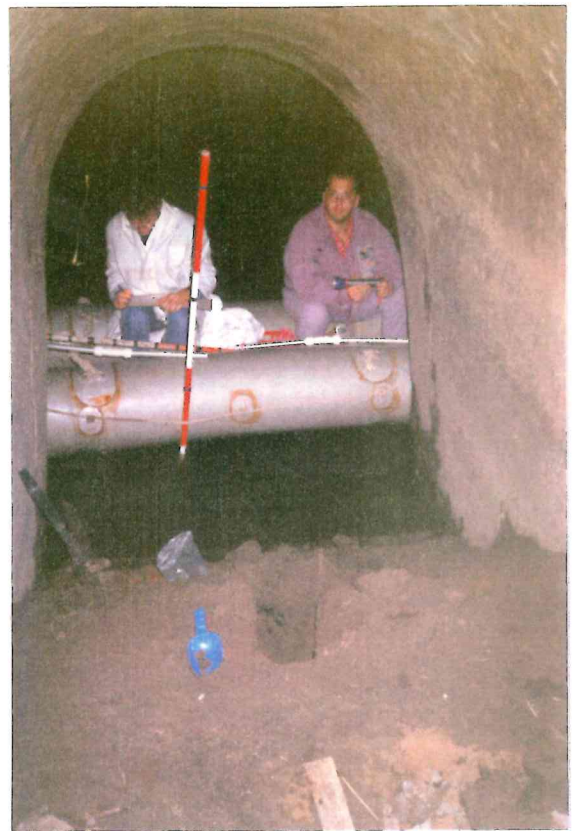
Abb.5.1.7: Schlammablagerungen in einer Nische der Gerberröhre
