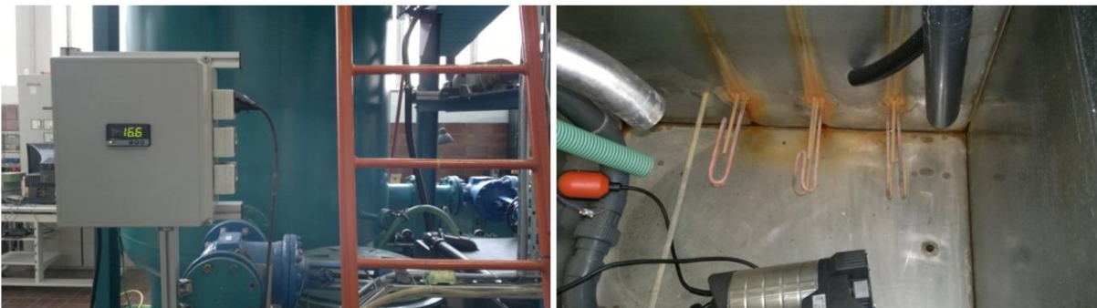
Abb. A-23: Zentrales Steuermodul der Heizspiralen (links) und Heizspiralen im Pufferbecken (rechts)
