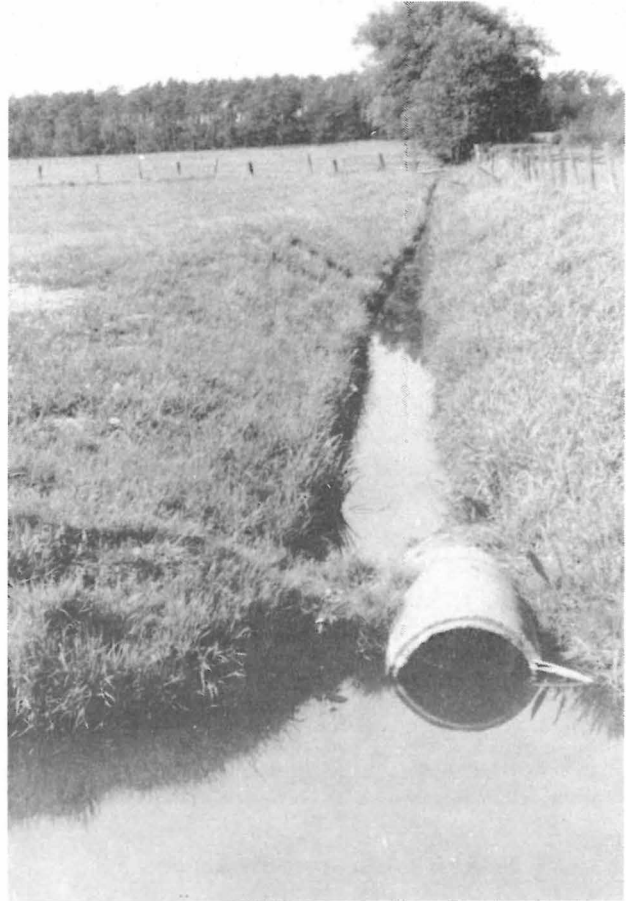
Photo 6 Rückstau vom Haupt- in einen Nebenvorfluter (Augraben)
