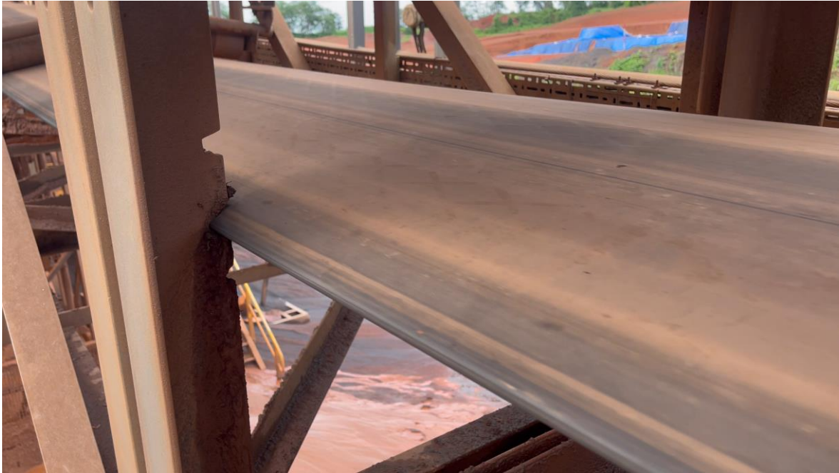
Bild 3: Beschädigung der Anlagenkonstruktion durch Gurtschieflauf
