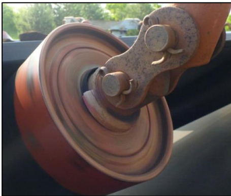
Bild 4: Defekte Lagerabdichtung an einer Tragrolle des Herstellers A, die im Folgenden zum Eindringen von Verunreinigungen in das Wälzlager führt [LEAG]
