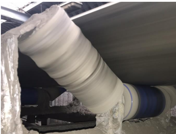
Bild 7: Verstärkte Materialanbackungen an einer Stahlrolle
